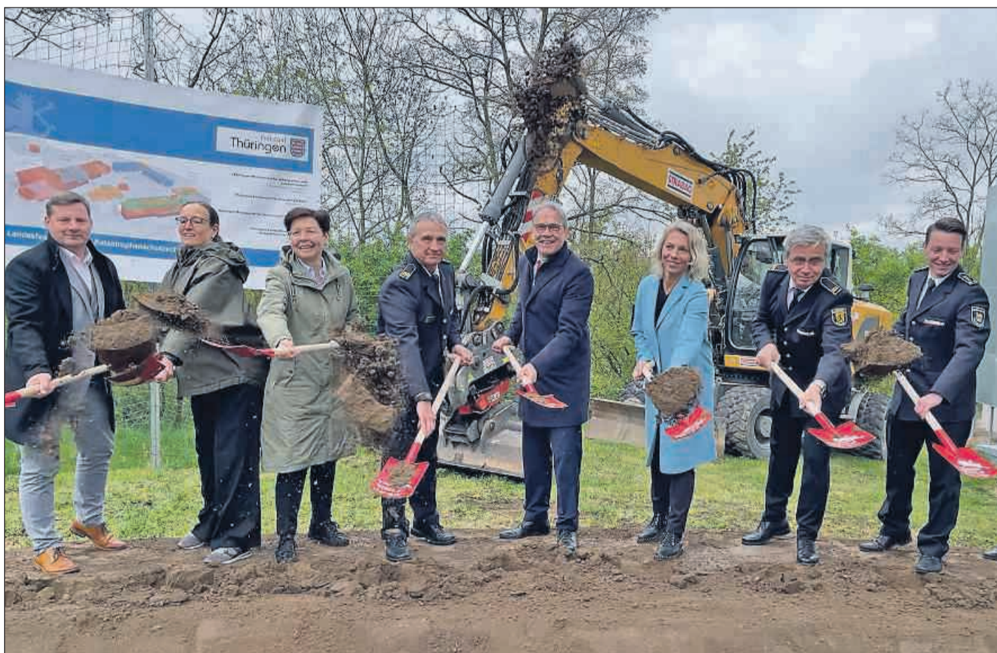
Mit Susanna Karawanskij, Heike Taubert und Georg Maier waren drei Thüringer Minister am Montag vor Ort, um den Spatenstich zur Erweiterung und komplexen Sanierung der Thüringer Landesfeuerwehr- und Katastrophenschutzschule Bad Köstritz zu vollziehen. Foto: Jens Lohse
