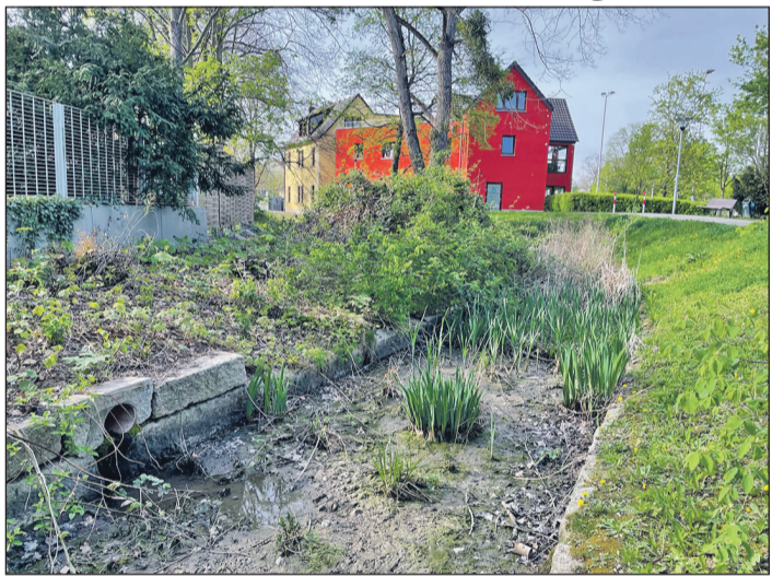
Trostloser Anblick am Hofwieseparkplatz. Früher mußte der Mühlgraben regelmäßig geschlämmt werden, um die Bildung einer Kloake zu verhindern. Nach der Verrohrung des Fließes gab es immer mal wieder die Idee, den Graben zu fluten. Kein Geld. Foto: J. Lohse
